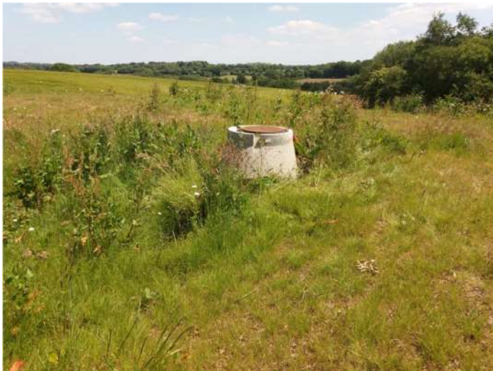
Exemple de buse équipée d'une sonde de turbidité en aval du bassin de rétention
