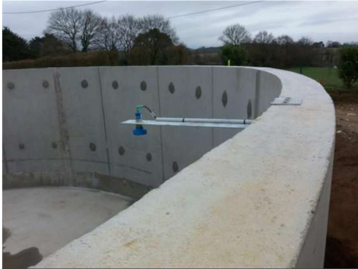
Sonde antidébordement à ultrason en projet sur les 3 fosses extérieures
