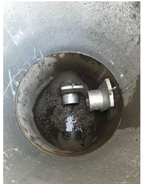
Puits de répartition des lisiers avec vannes gullotines
